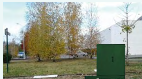
Implantation de l'armoire de rue située à Alpagespace
