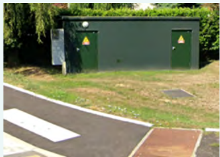
Armoire de type "Shelter" installée à Francin
